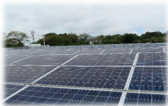
太陽光発電所
