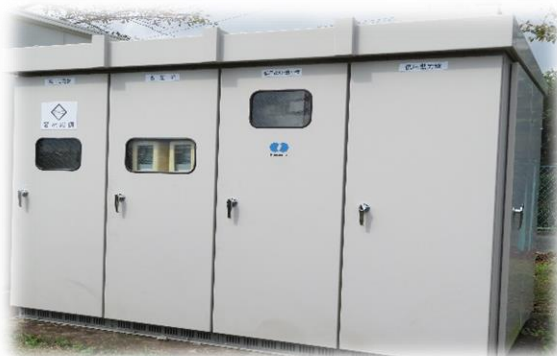
キュービクル式受変電設備
